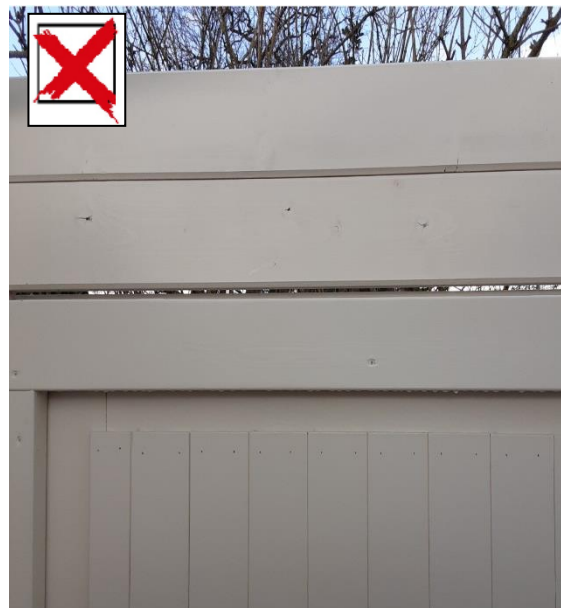
Figuur 5: Op deze foto is niet te herleiden waar het probleem zich voordoet een foto van afstand kan gekeken worden hoe de deur gemonteerd is.
