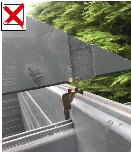
Figuur 4: Foto van te dichtbij gemaakt. Niet te zien wat exact het probleem is.
