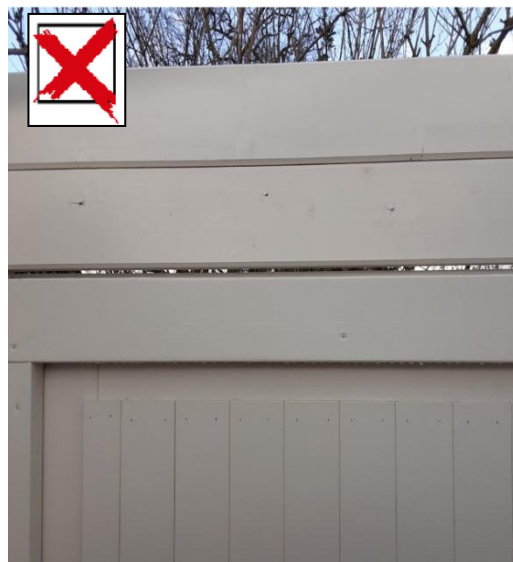
Figur 5: Anhand dieses Fotos lässt sich nicht feststellen, wo das Problem auftritt. Auf einem Foto aus der Ferne lässt sich erkennen, wie die Tür montiert ist.
